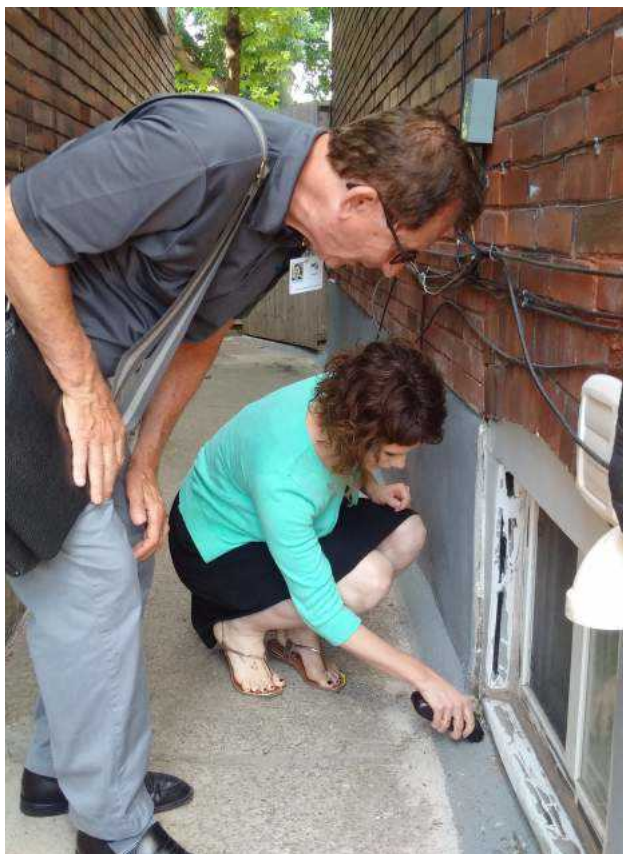
Lindsay Bunce, propriétaire, mesure le taux d'humidité des fondations avec l'aide de Larry Freiburger, évaluateur des risques d'inondation. Toronto, 2018.
